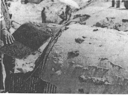
الشكل (٧) انكسار في الانابيب الخرسانية الاسطوانية (ccp)
